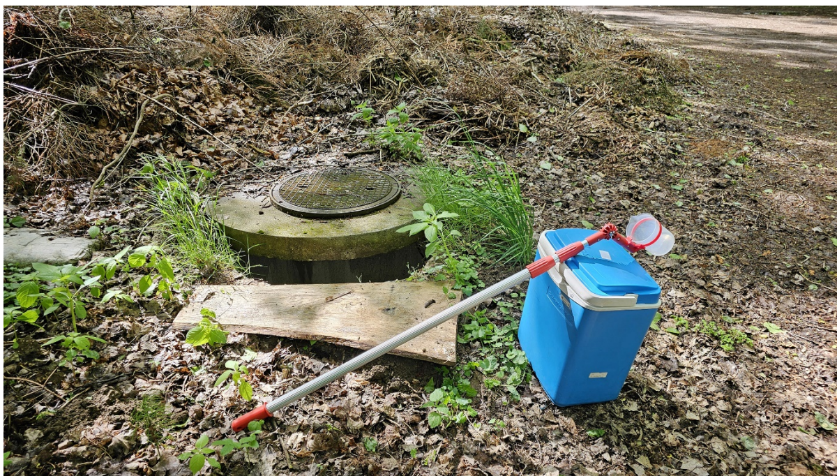
Vstup do revizní šachty s teleskopickým odběrákem a termoboxem pro uchování vzorků.
